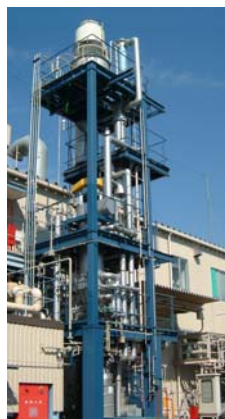
【溶剤回収装置】
