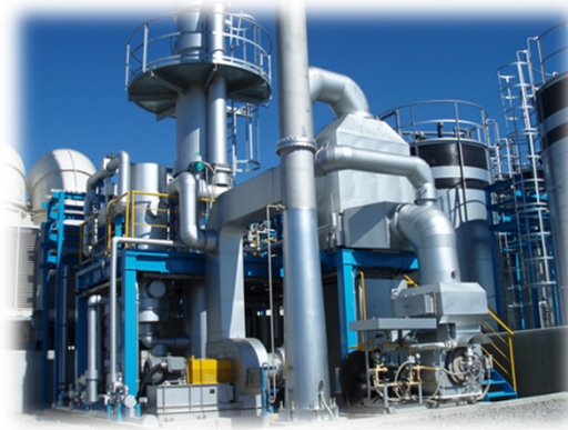
アンモニア処理システム アンモニアの回収 アンモニアの無害化(触媒脱臭)
