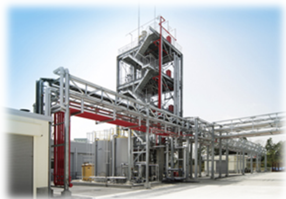
廃溶剤回収装置
