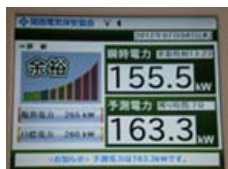
[デマンド監視装置導入] 電力使用の見える化
