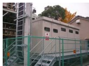
[受変電設備改修] トップランナー機器へ
