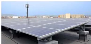
[新社屋屋上に太陽光発電23KW増設]
