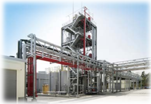
廃溶剤回収装置
