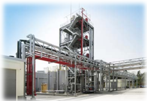
廃溶剤回収装置
