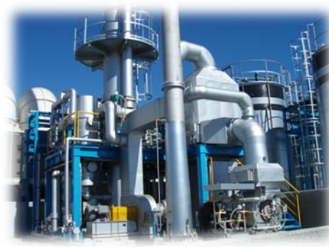
アンモニア処理システム
