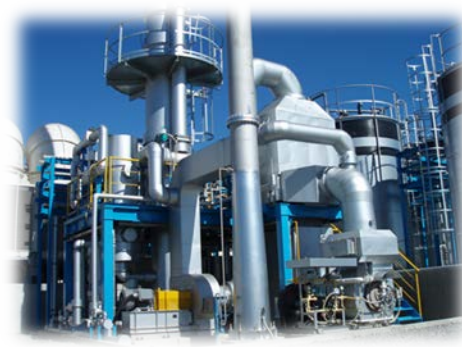
アンモニア処理システム
