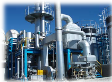
アンモニア処理システム
