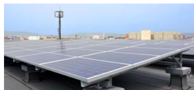
[新社屋屋上に太陽光発電23KW増設]
