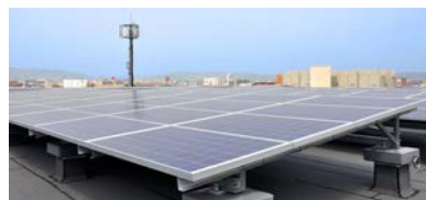
[新社屋屋上に太陽光発電23kW増設]
