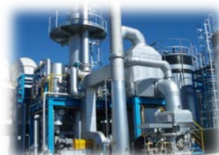
アンモニア処理システム
