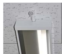
[人感センサー付照明の採用] [事務所照明はLED採用]
