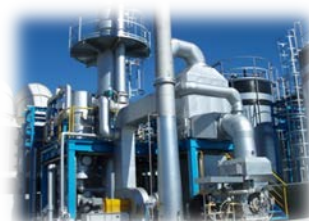
アンモニア処理システム
