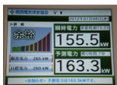
【デマンド監視装置導入】
